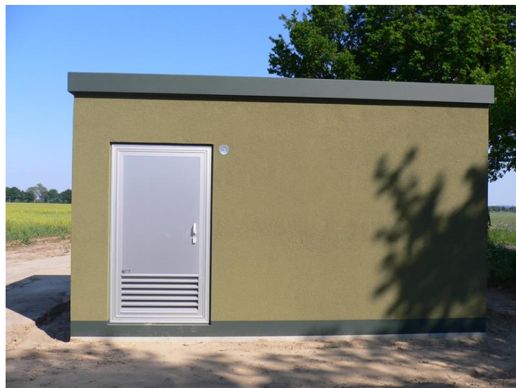
Figure 5 : Illustration du poste de livraison du parc éolien de Pierre-Morains (source : WKN France, 2018)
